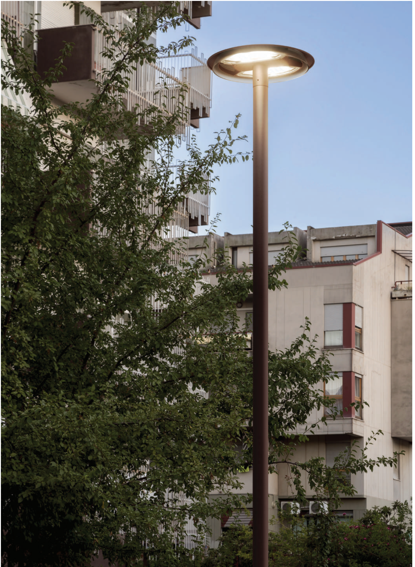
Erneuerung der öffentlichen Beleuchtung in Rende, Italien - Produkt: Twilight Calgary - Mastaufsatz | Rostbraun Ph: Stefano Ferrando, Studio Vetroblu
