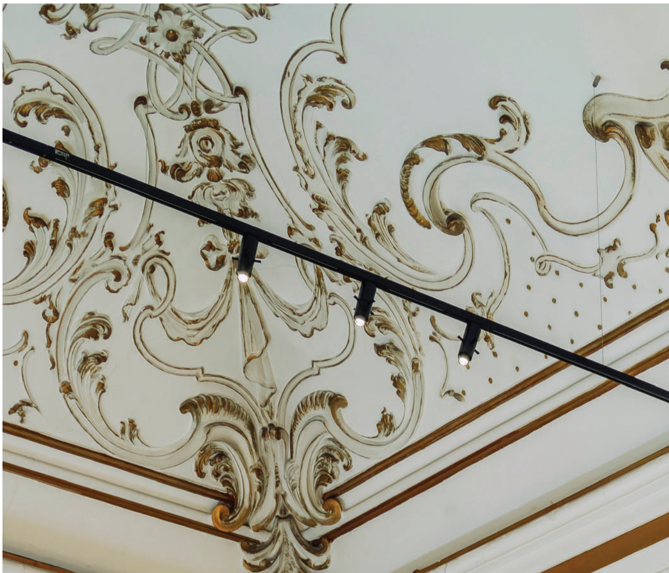
Oficinas de Wilmotte & Associates Architects - Milán, Italia — Producto: Raíl de baja tensión - Palco Baja Tensión | Ø37 mm | Negro Ph: Stefano Anzini
